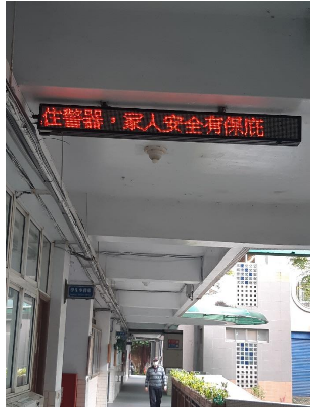
走廊跑馬燈宣導-安裝住宅警報器
